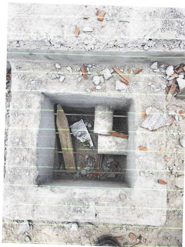
Foto 08 – Tubo pvc, serie normal, esgoto predial, dn 100 mm, fornecido e instalado em prumada de esgoto sanitário ou ventilação. af_12/2014
