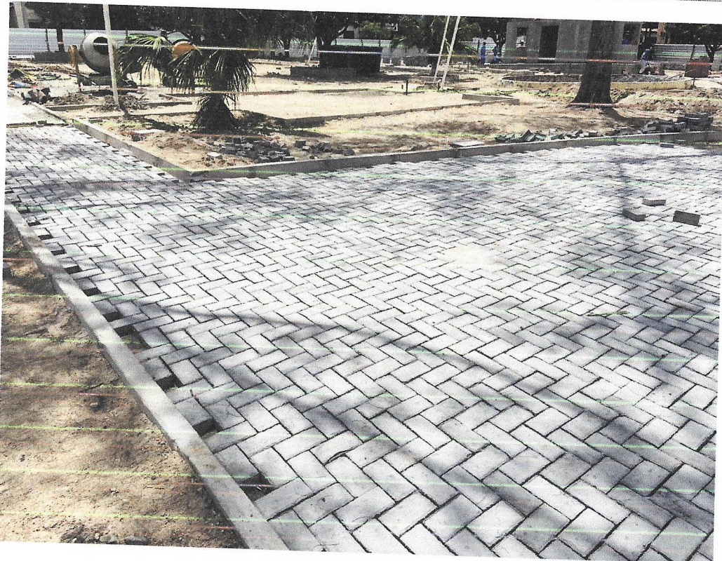
Foto 15 - Execução de pátio/estacionamento em piso intertravado, com bloco retangular colorido de 20 x 10 cm, espessura 8 cm. af_12/2015
