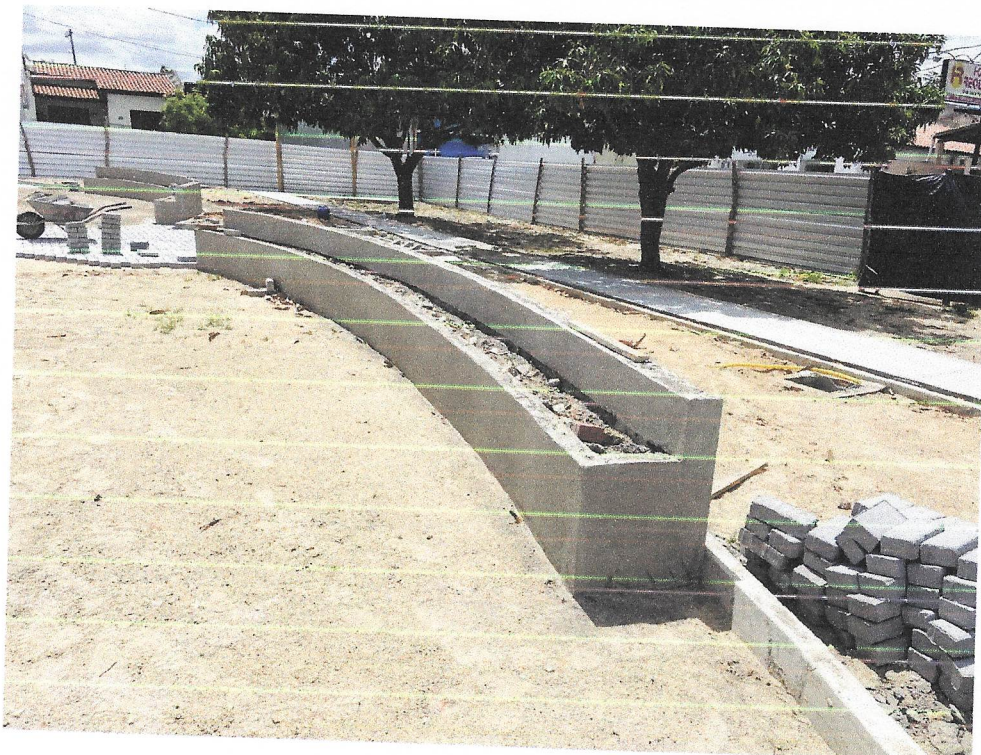
Foto 14 – Massa única, para recebimento de pintura, em argamassa traço 1:2:8, preparo mecânico com betoneira 400l, aplicada manualmente em faces internas de paredes, espessura de 10mm, com execução de taliscas. af_06/2014
